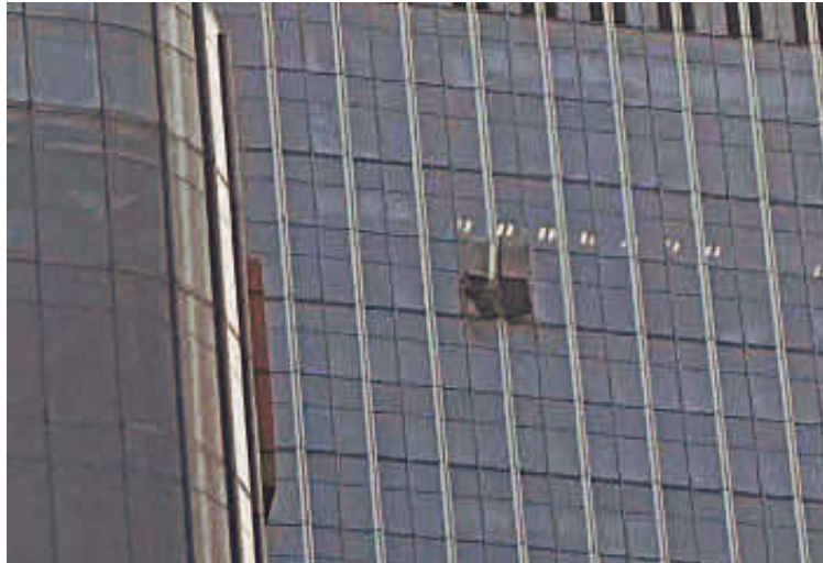
Fotografía que muestra un panel de vidrio dañado en la fachada. EFE
